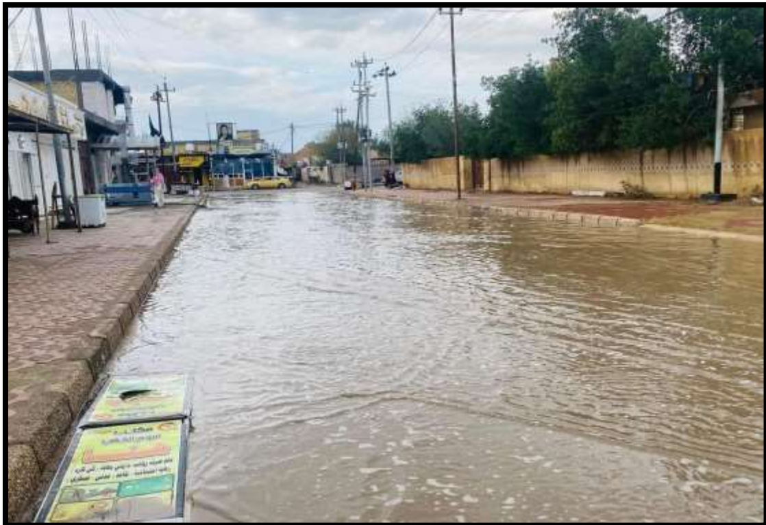
صورة (5) توضح اثر الامطار على الطرق في منطقة الدراسة (الخضر شارع الاندلس)
