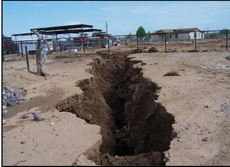
صورة (٤) هبوط ارضي بسبب الضخ المكثف للمياه الجوفية .
